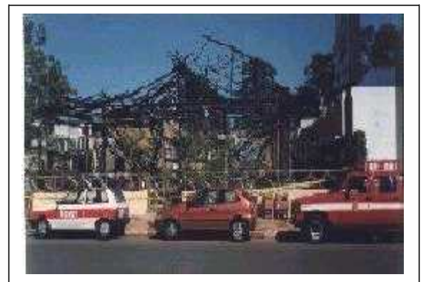
Figura 2 - Incêndio em edificação com cobertura de fibras vegetais (ocupação de bar e restaurante)
